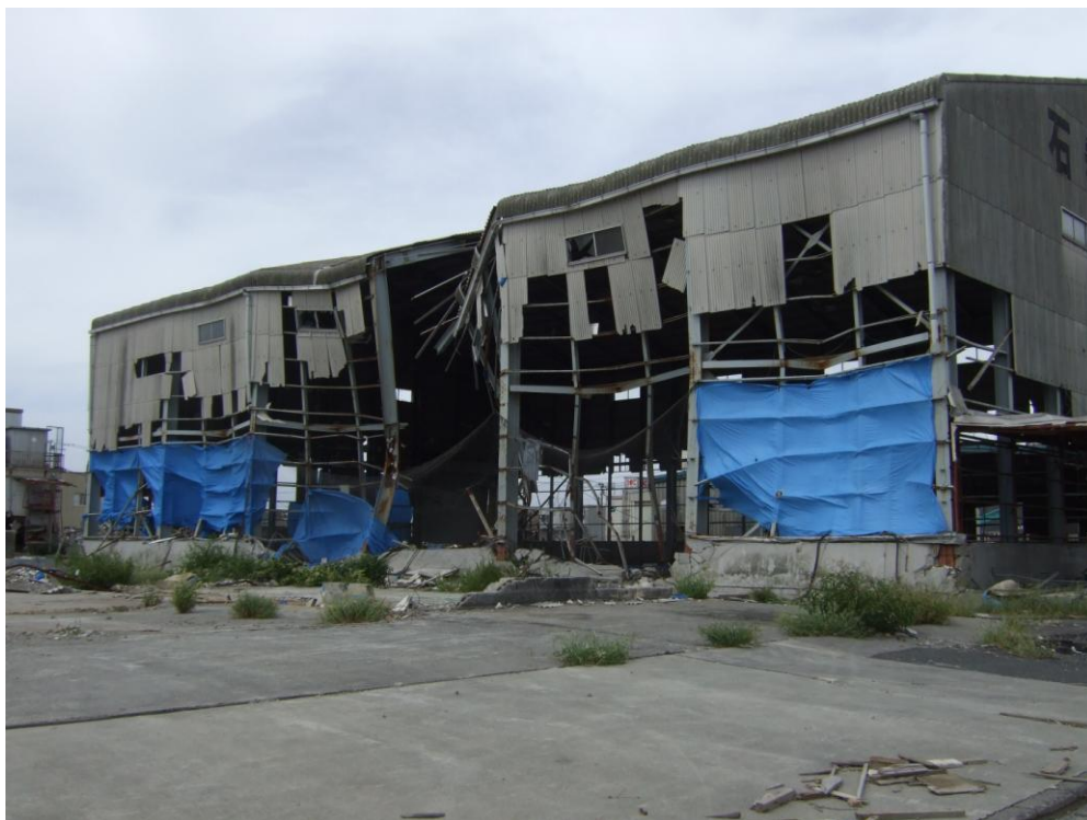
写真 7：石巻市の漁港近くの津波で破壊された工場。
